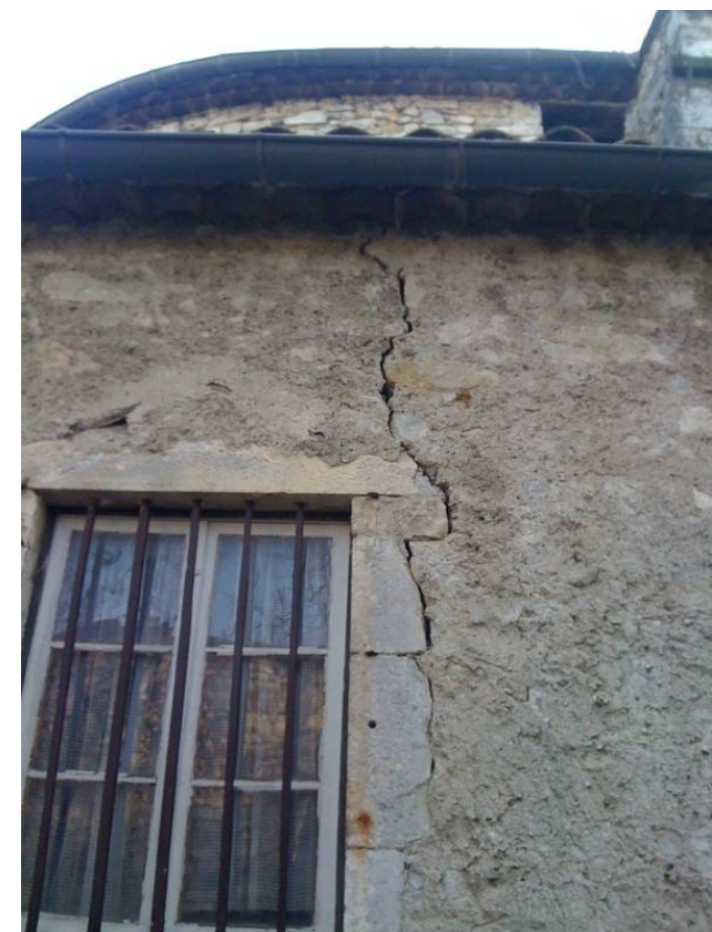
Fissures mur Nord (2010)
