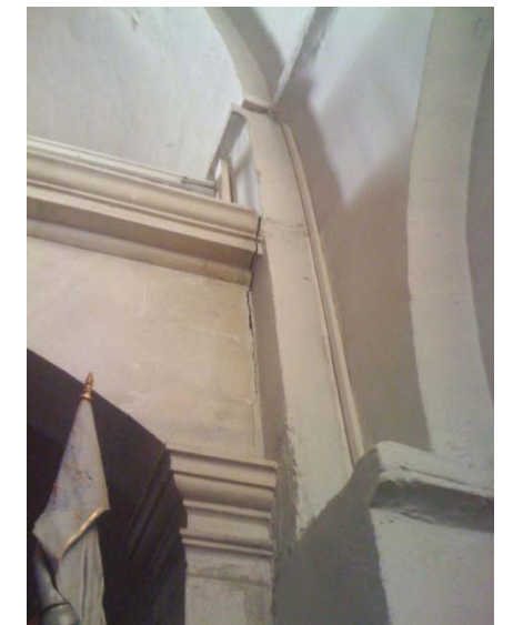
Fissure sur la tribune (2010)
