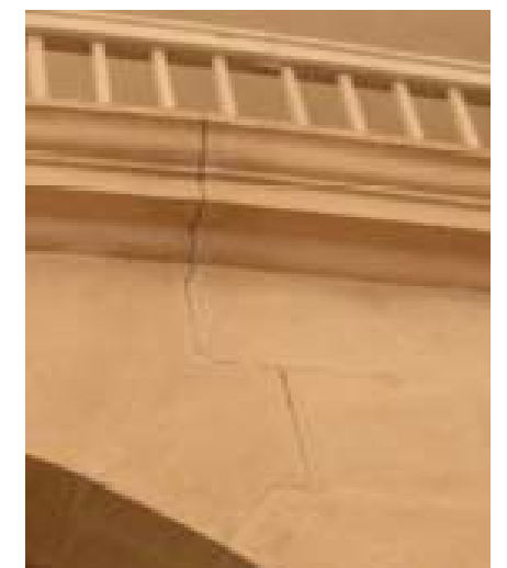
Fissure sur la tribune (2010)
