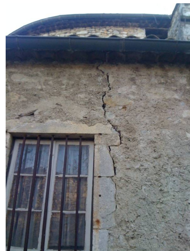
Fissures mur Nord (2010)
