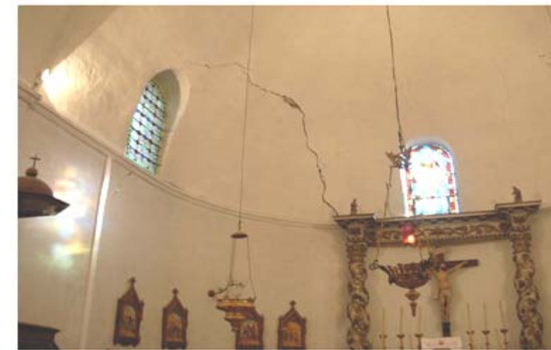
Fissure en bas de voûte dans le chœur(1975)
