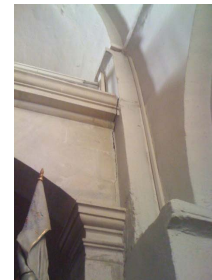
Fissure sur la tribune (2010)
