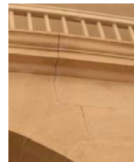
Fissure sur la tribune (2010)
